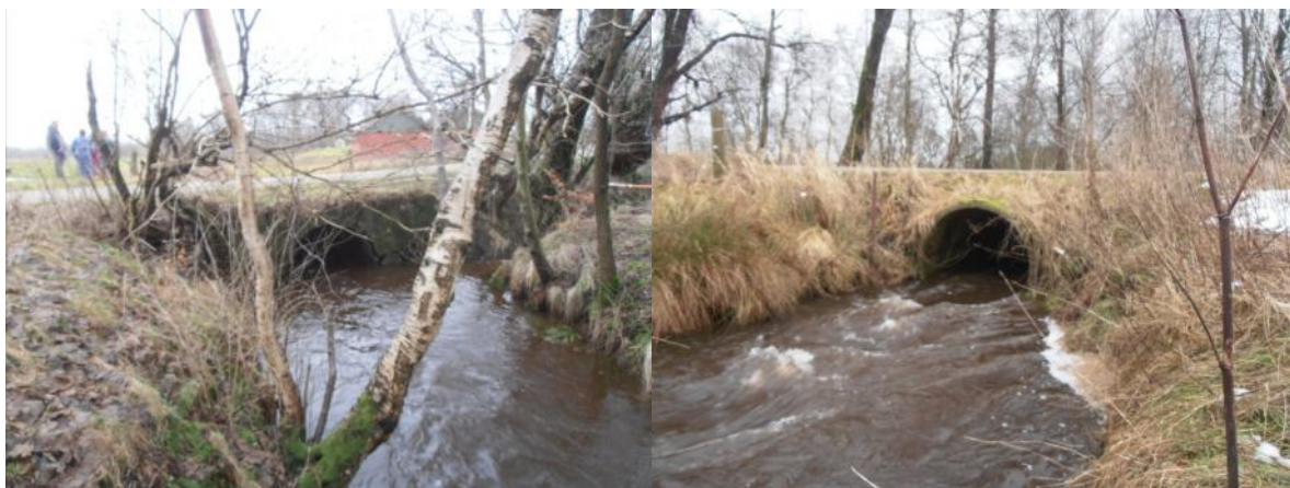
Figur 2 Underføringen ved Sekærvej, tv. set fra opstrøms side og th. set fra nedstrøms side
