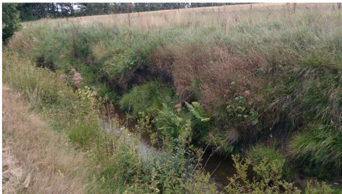
Figur 18 Erosion i eksisterende skråningsanlæg mod syd.
